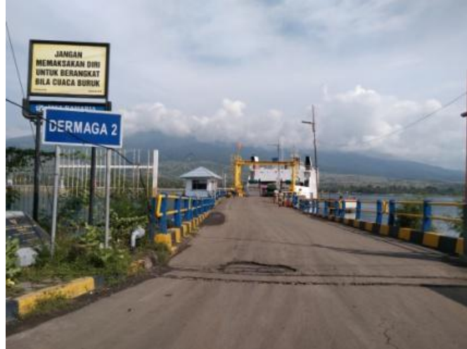
Gambar 5.3 Kondisi Jalan Akses Menuju Dermaga
