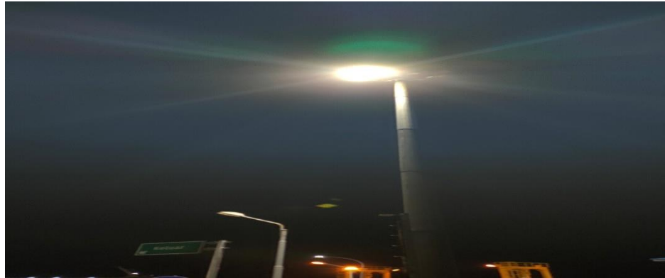
Gambar 4.4 Lampu Penerangan di Pelabuhan Penyeberangan Bakauheni
