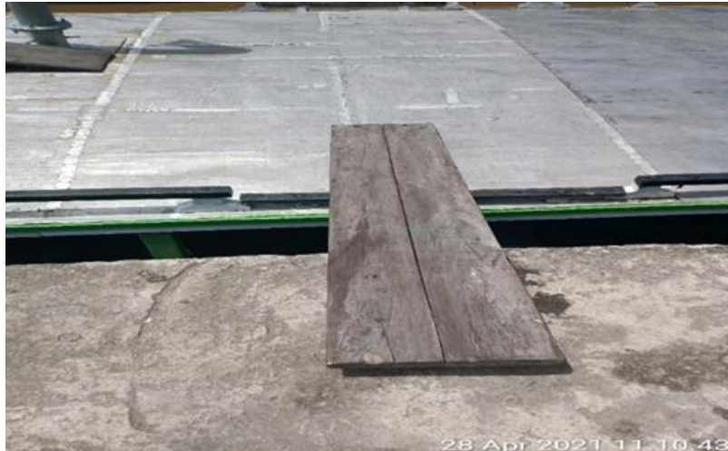
Gambar 4.12 Fender diPelabuhan Sungai Rasau Jaya
