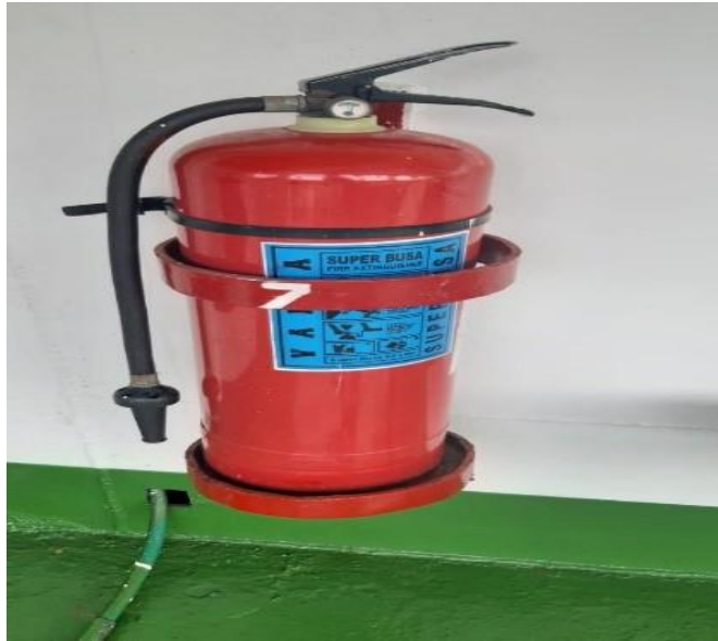
Gambar 5. 13 Kondisi Eksisting Fire Ekstinguisher pada KMP.Nusa Penida
