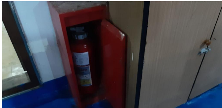
Gambar 5. 15 Kondisi Eksisting Fire Extinguisher pada KMP.Nusa Sakti
