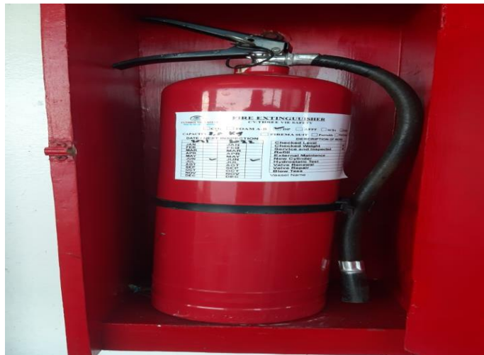
Gambar 5. 14 Kondisi Eksisting Fire Ekstinguisher pada KMP.Nusa Bhakti
