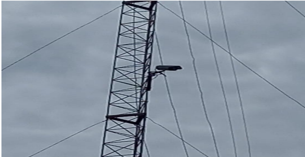
Gambar 5. 4 CCTV Berada Di Tower
