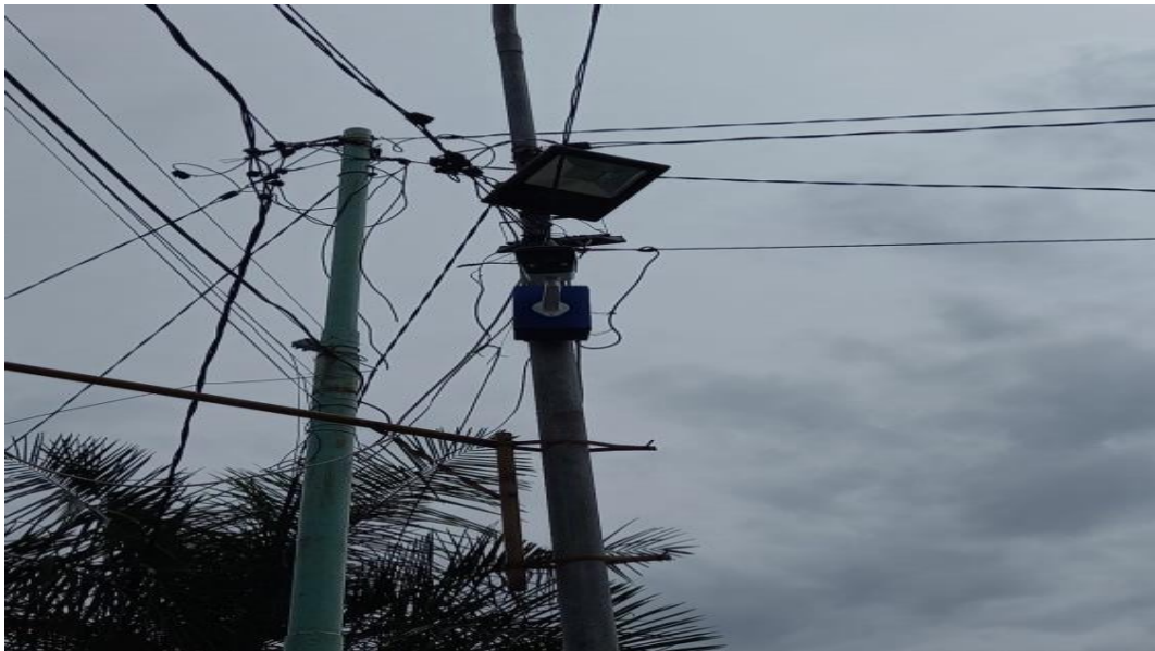
Gambar 5. 3 CCTV Berada Di Tiang Listrik
