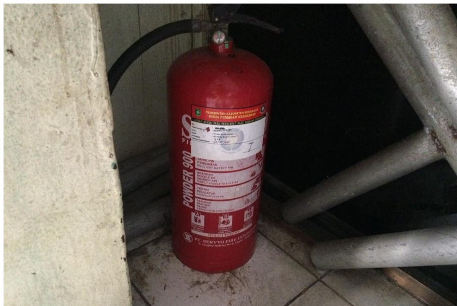
Gambar 4. 27 Alat Pemadam Kebakaran
