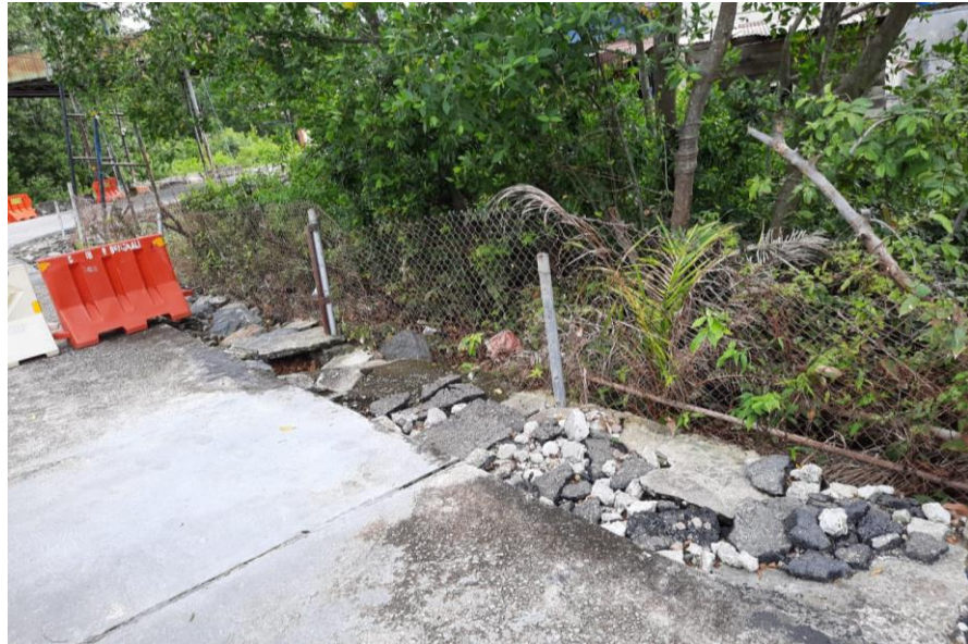
Gambar 5. 29 Kondisi Jalan yang Rusak pada Jalur Kendaraan Penumpang Menuju Area Parkir Siap Muat
