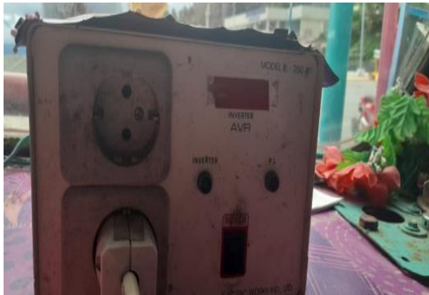
Gambar 5.1 Inverter yang ada di kapal
