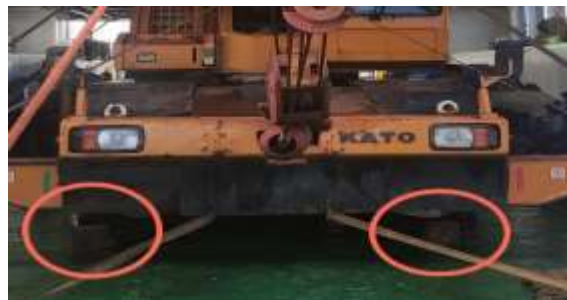
Gambar 4.17 Tidak dilakukan Klem Roda Kendaraan
