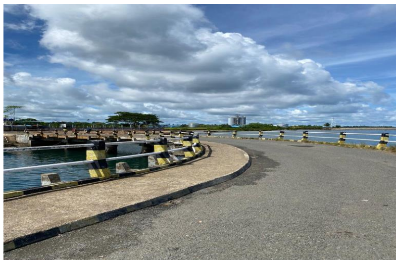
Gambar 4.10. Trestel Pelabuhan Arar Sumber : Laporan PKL BPTD Wilayah XXV Provinsi Papua & Papua Barat 2022
