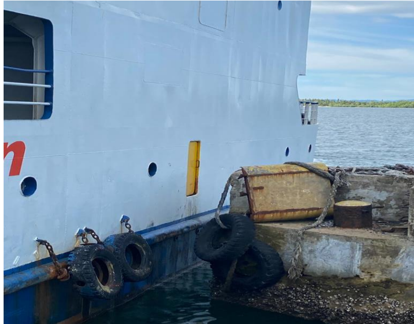
Gambar 4.13. Fender Pelabuhan Arar
