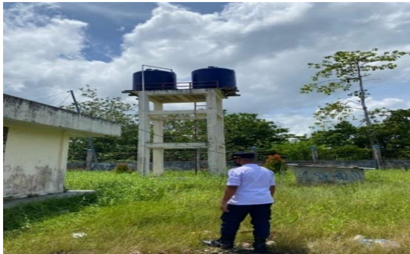
Gambar 4.8. Penampungan Air Pelabuhan Penyeberangan Arar Sumber : Laporan PKL BPTD Wilayah XXV Provinsi Papua & Papua Barat 2022
