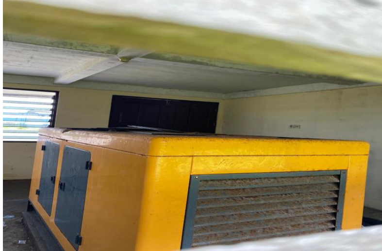
Gambar 4.7. Generator Pelabuhan Penyeberangan Arar Sumber : Laporan PKL BPTD Wilayah XXV Provinsi Papua & Papua Barat 2022
