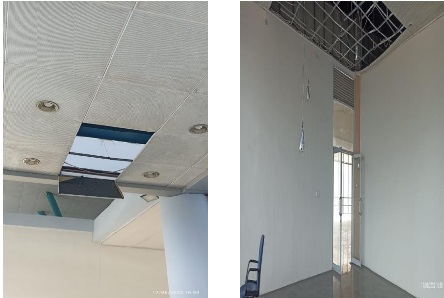
Gambar 4.24 Kondisi ruang tunggu yang tidak terawat
