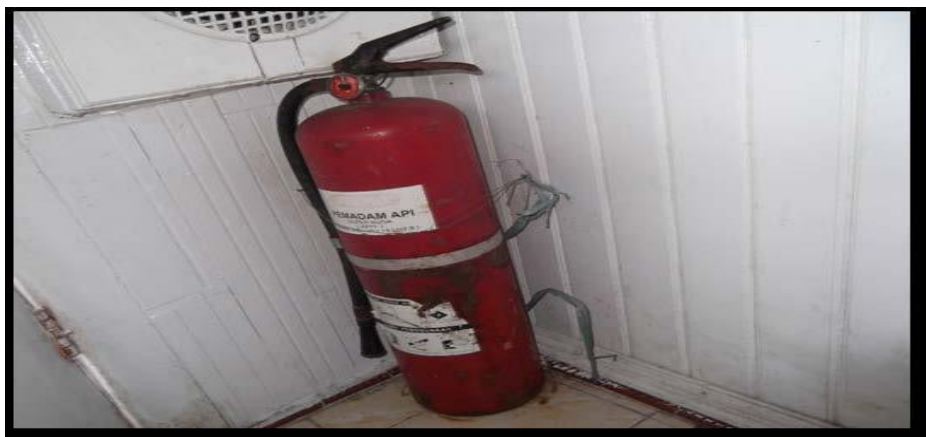
Gambar 4.31 Alat Pemadam Kebakaran
