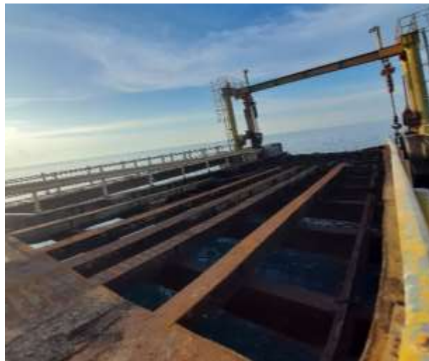
Gambar 4. 18 Dermaga Movable Bridge yang Rusak
