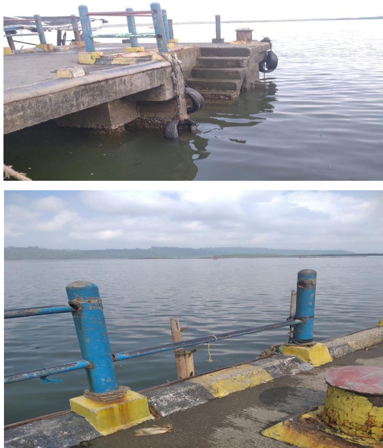
Gambar 4.12 Kondisi Besi Pembatas Pada Trestle
