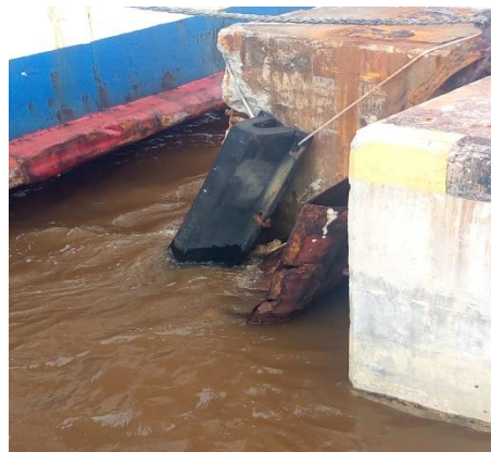
Gambar 4.36 Kondisi Fender yang Rusak Sumber : Dokumentasi Tim PKL Jambi 2022
