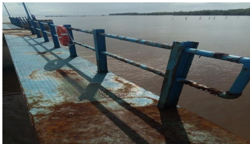
Gambar 4.39 Catwalk yang Berkarat dan Pagar Pembatasnya Sumber : Dokumentasi Tim PKL Jambi 2022
