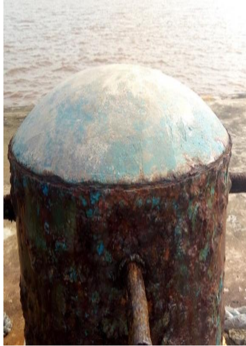
Gambar 4.38 Bolder yang Berkarat Sumber : Dokumentasi Tim PKL Jambi 2022
