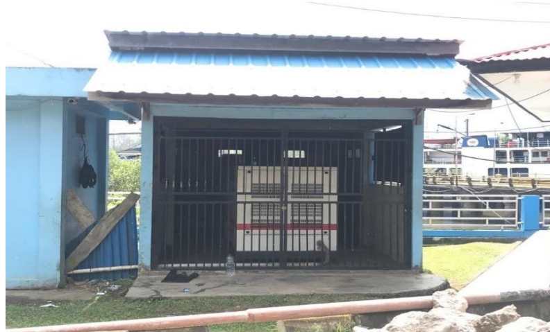
Gambar 4.15 Instalasi Listrik Pelabuhan Kariangau
