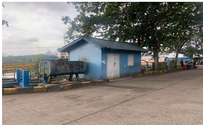
Gambar 4.14 Instalasi Air Pelabuhan Kariangau
