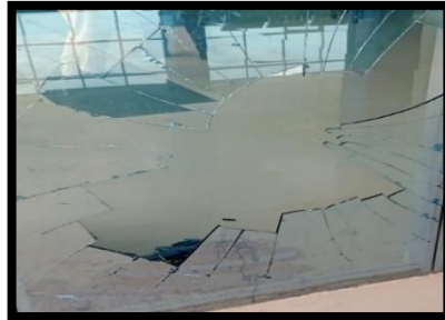
Gambar 4.37. Kondisi Ruang Tunggu Rusak Sumber: Dokumentasi TIM PKL SULUT, 2022
