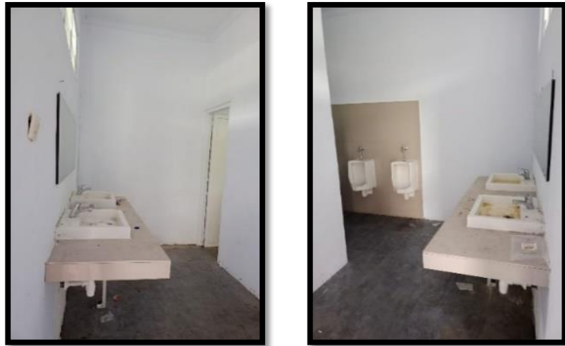
Gambar 4.13. Toilet Wanita dan Toilet Pria di Pelabuhan Penyeberangan Likupang Sumber: Dokumentasi TIM PKL SULUT, 2022
