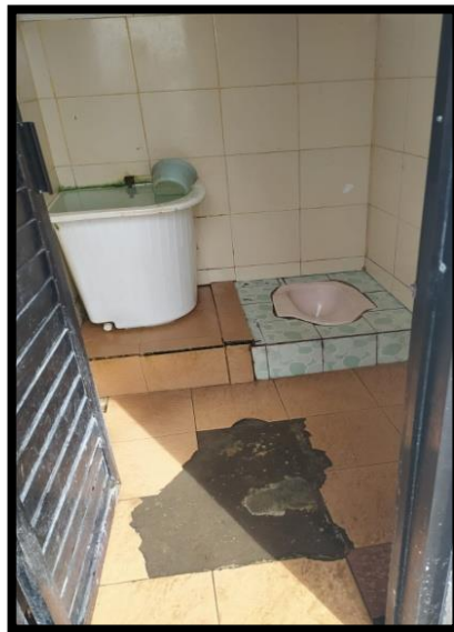
Gambar 4.19 Toilet / WC Sumber : Laporan PKL BPTD Wil XIII,2022
