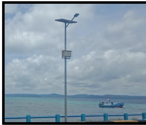
Gambar 4.13 Lampu Penerangan di Area Pelabuhan Sumber : Laporan PKL BPTD Wil XIII,2022
