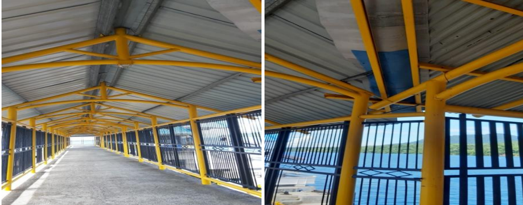
Gambar 4.45 Lajur Gangway tanpa adanya CCTV
