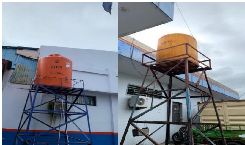
Gambar 4. 21 Penampungan Air Bersih
