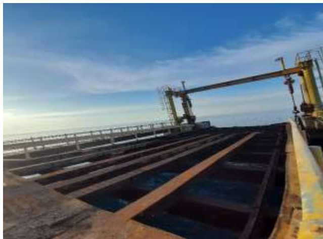
Gambar 4. 21 Dermaga Movable Bridge yang Rusak
