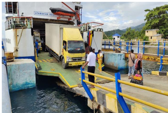
Gambar 1. 2 Kondisi Pintu Rampa KMP. Merak
