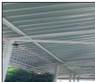
Gambar 4. 40 CCTV di Gangway
