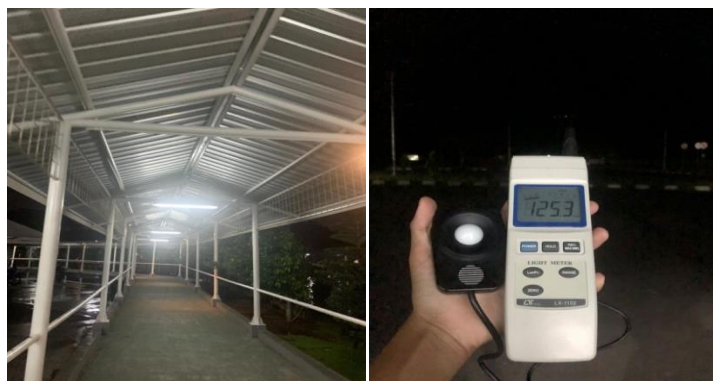
Gambar 4. 45 Lampu Penerangan di Gangway
