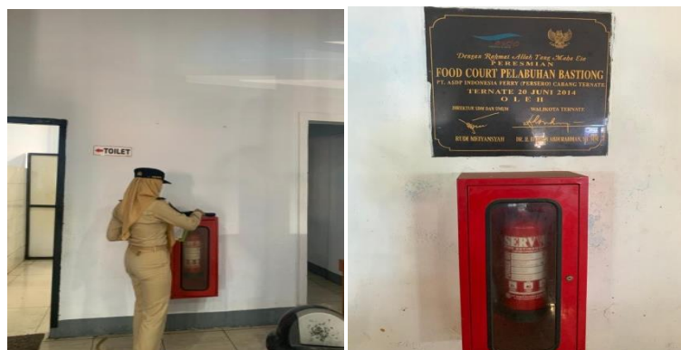
Gambar 4. 37 Apar pada Ruang Tunggu
