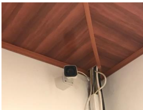
Gambar 4.34 CCTV di ruang tunggu
