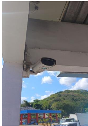
Gambar 4.37 CCTV di GANGWAY
