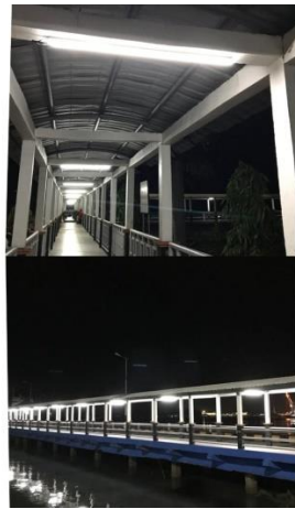
Gambar 4.38 Lampu Penerangan di GANGWAY
