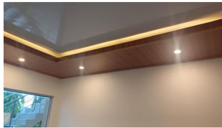
Gambar 4.36 Lampu Penerangan Ruang Tunggu
