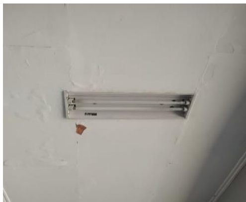
Gambar 4.35 Lampu Penerangan Ruang Tunggu
