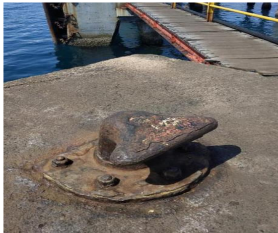
Gambar 4.14 Bolder Pelabuhan Penyeberangan Ketapang
