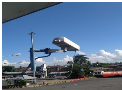
Gambar 4.25 CCTV Di Terminal
