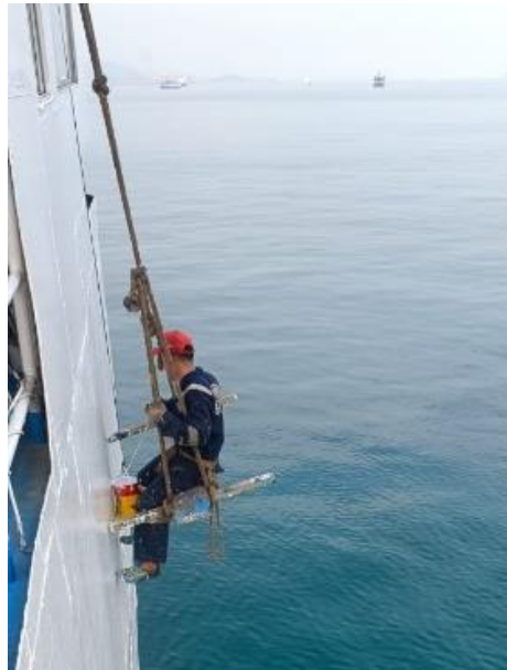
Gambar 4. 5 Peralatan Keselamatan Yang Tidak Layak Sumber : Dokumentasi Peneliti (2022).
