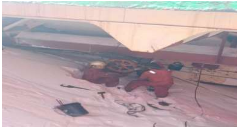
Gambar 1.1 Alat bongkar yang rusak dikarenakan pupuk urea yang membeku
