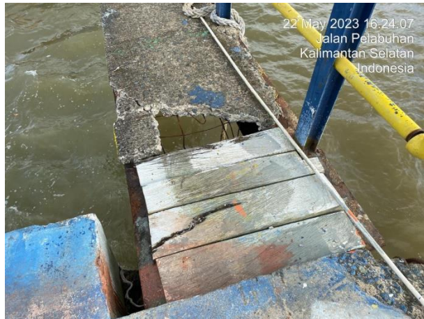
Gambar 4.43 Catwalk yang berlubang
