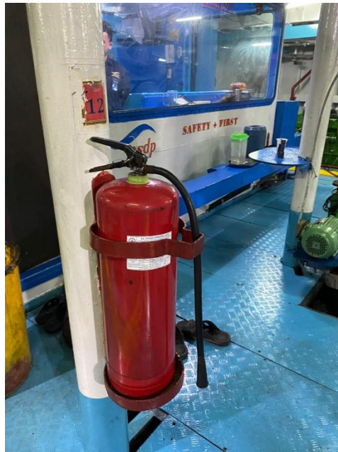
Gambar 2. 7 Fasilitas Pemadam Kebakaran
