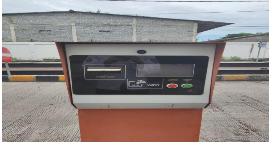
Gambar 4. 37 fasilitas Pengambilan Karcis Masuk Pelabuhan Yang Belum Berfungsi
