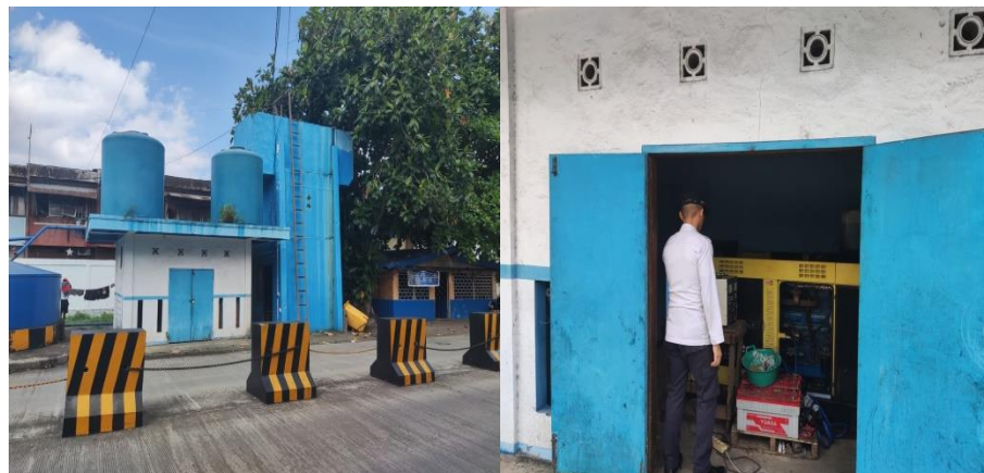
Gambar 4.9 Ruang Generator Pelabuhan ferry ASDP Bitung
