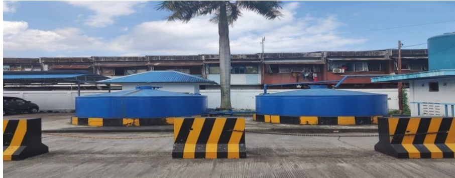
Gambar 4.10 Penampungan Air Bersih Pelabuhan ferry ASDP Bitung
