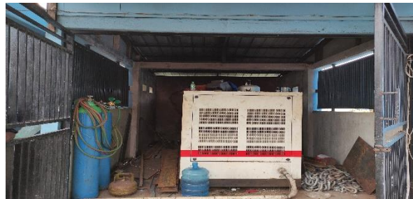
Gambar 4. 23 Gedung Instalasi Listrik
