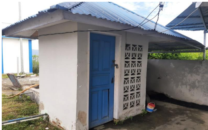
Gambar 4. 11 Ruang Instalasi Air
