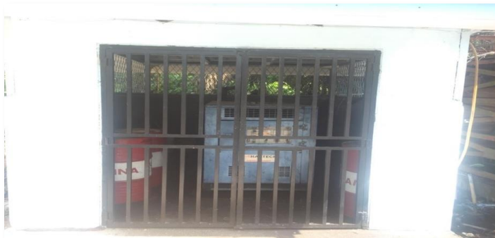
Gambar 4.28 Instalasi Listrik di Pelabuhan Penyeberangan Air Putih
