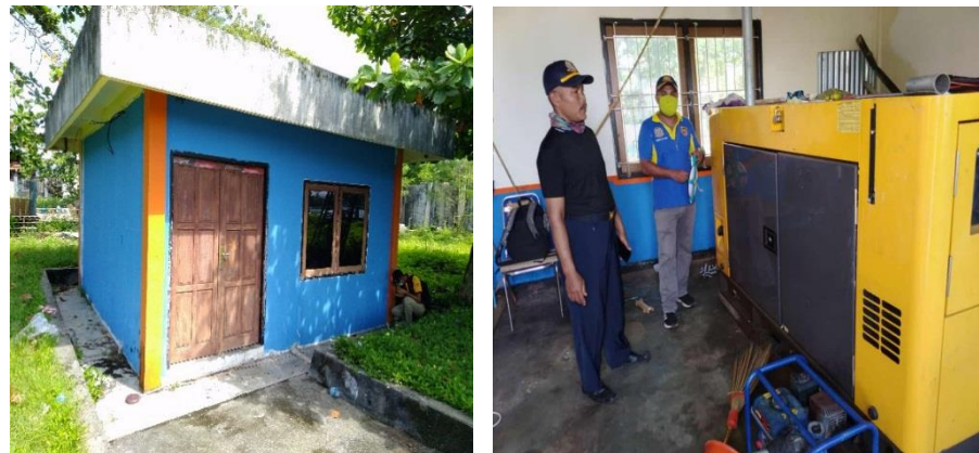
Gambar 4.10. Generator Pelabuhan Marampa
