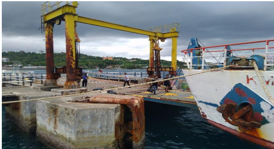
Gambar 4.16. Fender Pelabuhan Marampa
