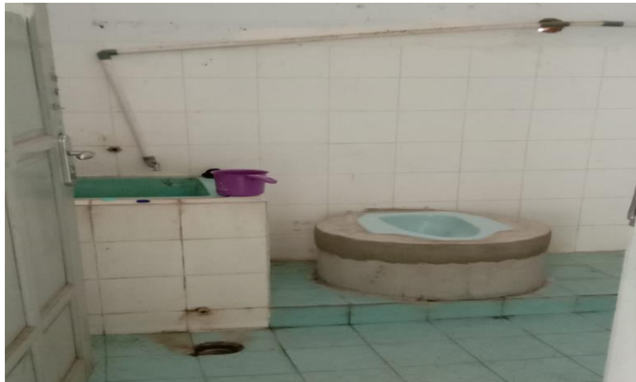
Gambar 5.10. Kondisi WC Pelabuhan Penyeberangan Bangsalae
