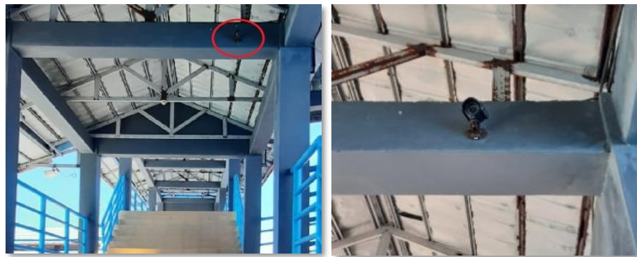
Gambar 5.1. CCTV di area Gangway
