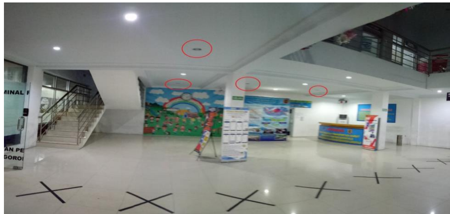
Gambar 5.6. Terdapat beberapa lampu yang rusak pada ruang tunggu
