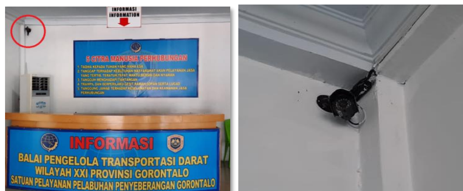
Gambar 5.2. CCTV di area Terminal Penumpang
