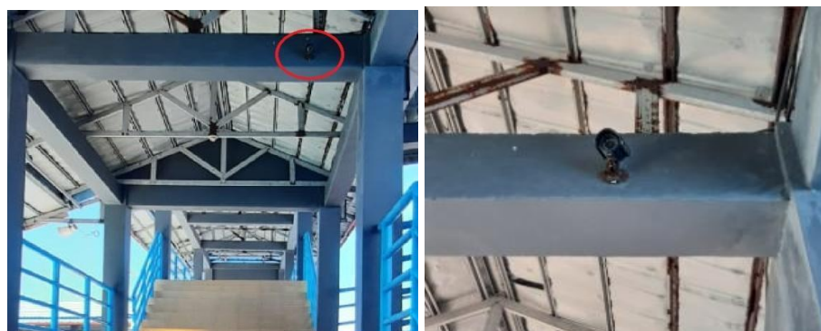
Gambar 5.1. CCTV di area Gangway
