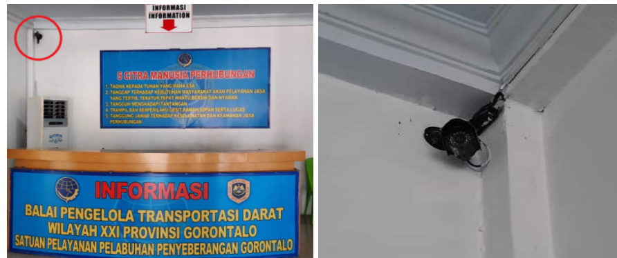
Gambar 5.2. CCTV di area Terminal Penumpang
