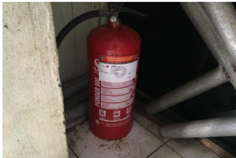
Gambar 4.24 Alat Pemadam Kebakaran
